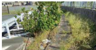
▲雑草が覆い茂っている歩道
